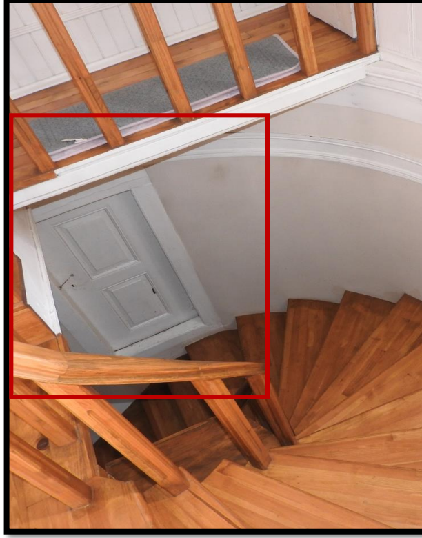
Görsel 343. Tescilli Ev 10, Birinci Kat Genel Görünüş ve Ara kat Kapısının Görünüşü (Trabzon Rölöve ve Anıtlar Müdürlüğü Sokak Sağlıklaştırma Projesinden)
