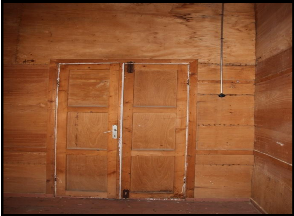
Görsel 152. Tescilli Ev 1, Birinci Kat Oda Görünüşü (Trabzon Rölöve ve Anıtlar Müdürlüğü Sokak Sağlıklaştırma Projesinden)
