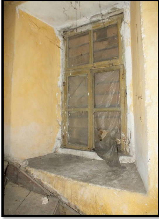
Görsel 191. Tescilli Ev 4, Zemin Kat Görünüşü (Trabzon Rölöve ve Anıtlar Müdürlüğü Sokak Sağlıklaştırma Projesinden)
