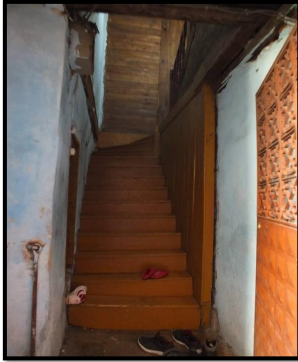
Görsel 218. Tescilli Ev 5, Birinci Kata Giriş ve Geçışı Sağlayan Kısımlardan Görünüş (Trabzon Rölöve ve Anıtlar Müdürlüğü Sokak Sağlıklaştırma Projesinden)
