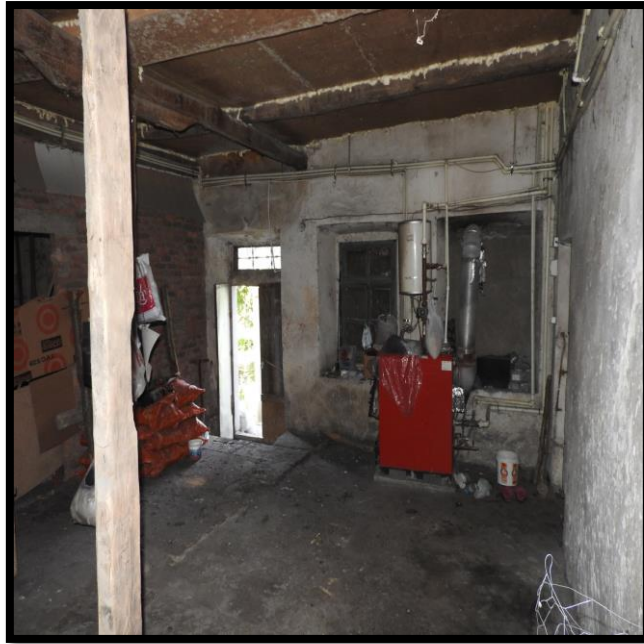
Görsel 338. Tescilli Ev 10, Bodrum Katı Görünüşü (Trabzon Rölöve ve Anıtlar Müdürlüğü Sokak Sağlıklaştırma Projesinden)
