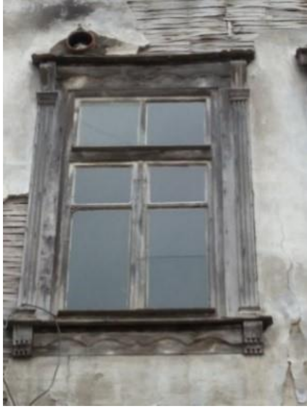
Görsel 155. Tescilli Ev 2, Batı Cephesi Pencere Detayı (Trabzon Rölöve ve Anıtlar Müdürlüğü Sokak Sağlıklaştırma Projesinden)
