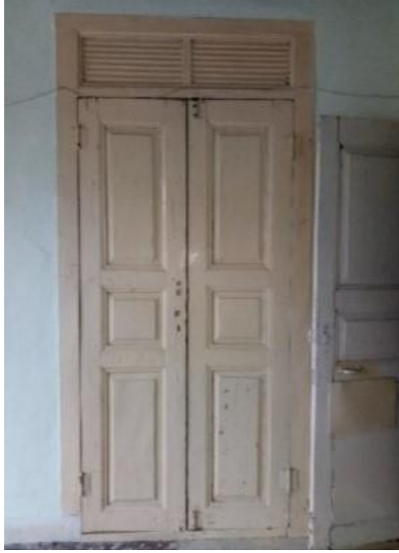
Görsel 163. Tescilli Ev 2, Birinci Kat Ahşap Kapı Tipleri (Trabzon Rölöve ve Anıtlar Müdürlüğü Sokak Sağlıklaştırma Projesinden)
