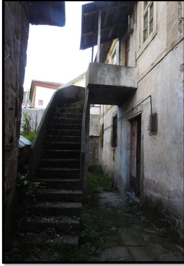
Görsel 299. Tescilli Ev 8, İkinci Kat Giriş Görünüşü (Trabzon Rölöve ve Anıtlar Müdürlüğü Sokak Sağlıklaştırma Projesinden)
