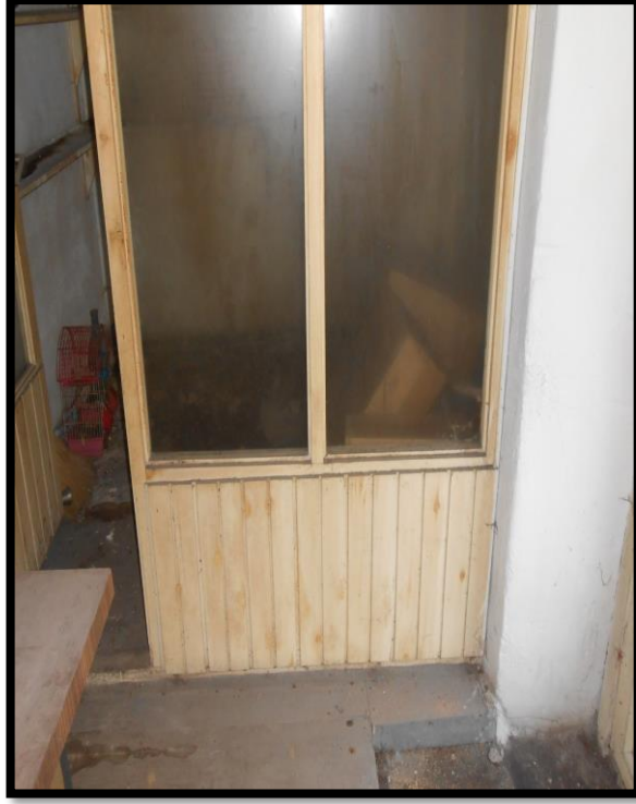
Görsel 355. Tescilli Ev 11, Yapının Zemin Katından Görünüş (Trabzon Rölöve ve Anıtlar Müdürlüğü Sokak Sağlıklaştırma Projesinden)
