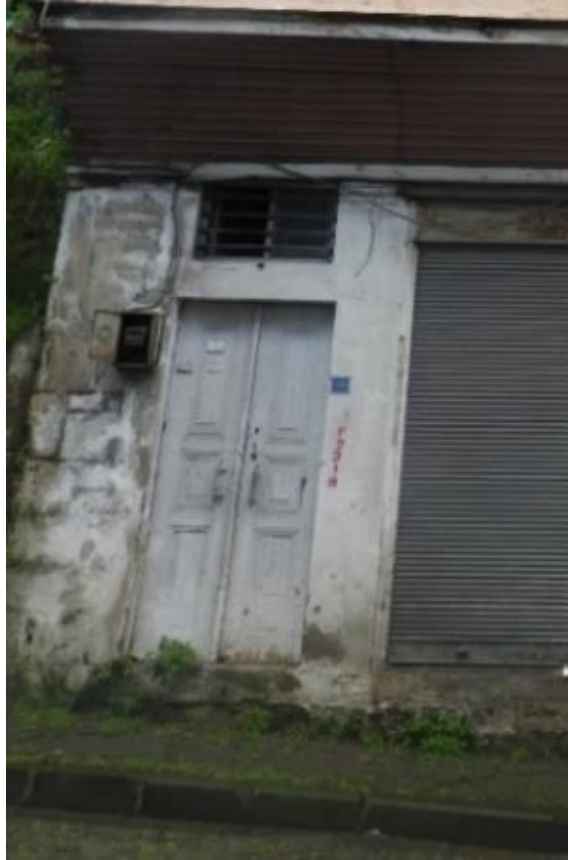
Görsel 356. Tescilli Ev 11, Zemin Katın Görünüşü (Trabzon Rölöve ve Anıtlar Müdürlüğü Sokak Sağlıklaştırma Projesinden)
