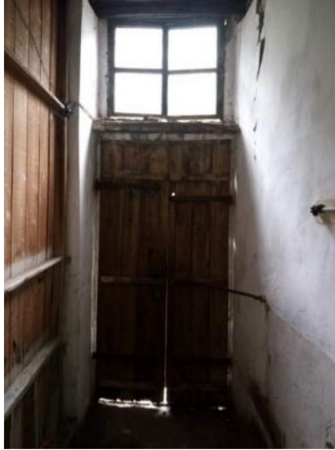
Görsel 158. Tescilli Ev 2, Birinci Kat Giriş Görünüşü (Trabzon Rölöve ve Anıtlar Müdürlüğü Sokak Sağlıklaştırma Projesinden)
