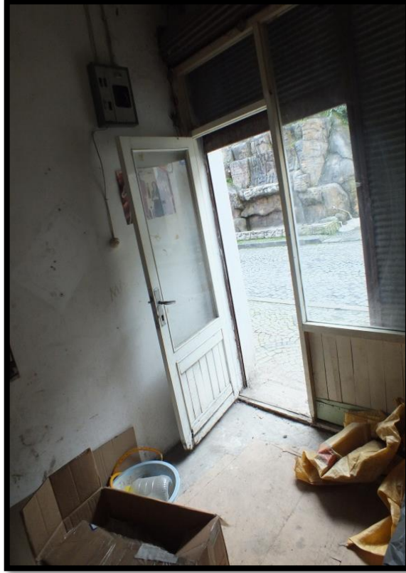
Görsel 379. Tescilli Ev 12, Zemin Kat Dükkân Görünüşü (Trabzon Rölöve ve Anıtlar Müdürlüğü Sokak Sağlıklaştırma Projesinden)
