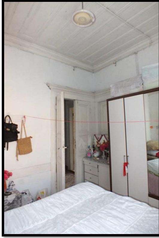
Görsel 329. Tescilli Ev 9, İkinci Kattan Görünüş (Trabzon Rölöve ve Anıtlar Müdürlüğü Sokak Sağlıklaştırma Projesinden)
