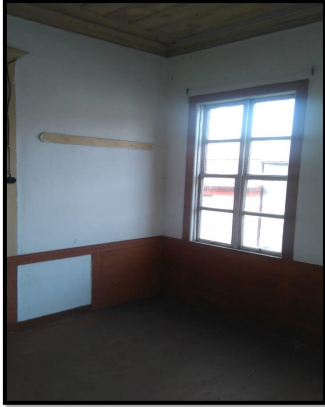
Görsel 371. Tescilli Ev 11, İkinci Katın Odasından Görünüş (Trabzon Rölöve ve Anıtlar Müdürlüğü Sokak Sağıklaştırma Projesinden)
