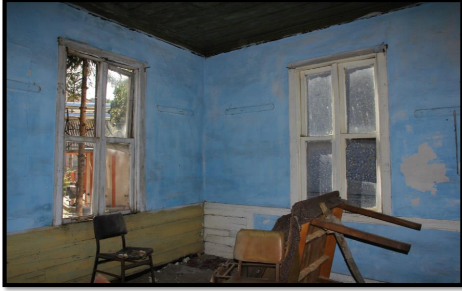
Görsel 179. Tescilli Ev 3, Birinci Kat Odalarının Görünüşü (Trabzon Rölöve ve Anıtlar Müdürlüğü Sokak Sağlıklaştırma Projesinden)
