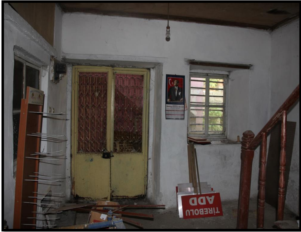
Görsel 140. Tescilli Ev 1, Zemin Kat Giriş Görünüşü (Trabzon Rölöve ve Anıtlar Müdürlüğü Sokak Sağlıklaştırma Projesinden)
