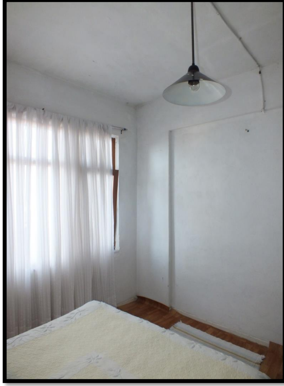
Görsel 387. Tescilli Ev 12, Zemin Kat İç Sofanın Açıldığı Odalar (Trabzon Rölöve ve Anıtlar Müdürlüğü Sokak Sağlıklaştırma Projesinden)
