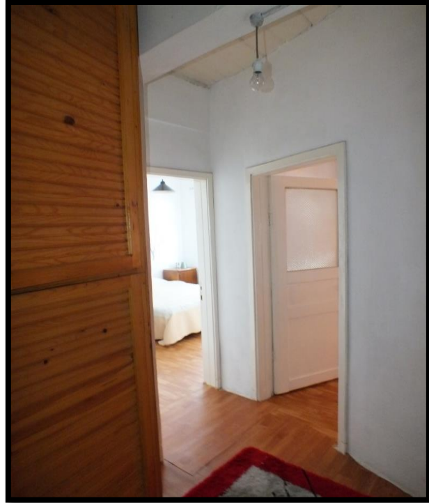
Görsel 384. Tescilli Ev 12, Zemin Kat Görünüşü (Trabzon Rölöve ve Anıtlar Müdürlüğü Sokak Sağlıklaştırma Projesinden)
