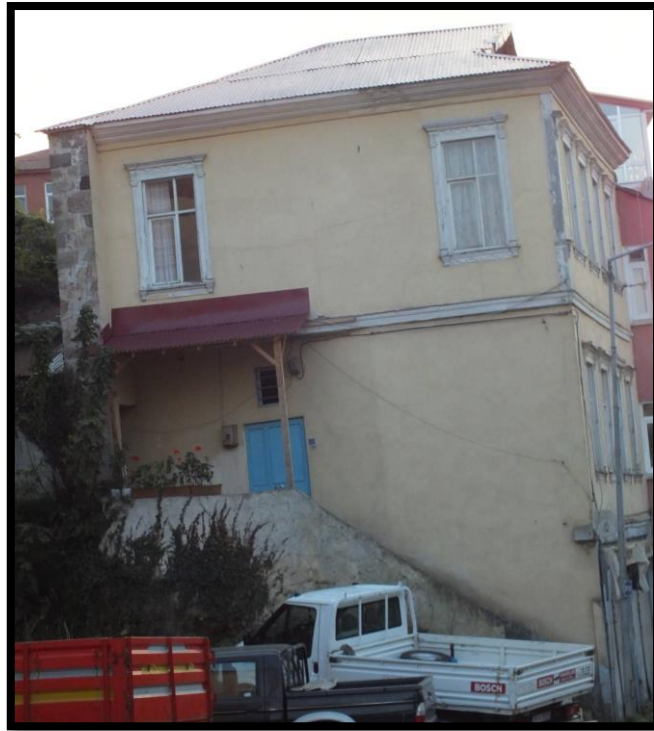
Görsel 316. Tescilli Ev 7, Batı Cephesi Görünüşü (Trabzon Rölöve ve Anıtlar Müdürlüğü Sokak Sağıklaştırma Projesinden)
