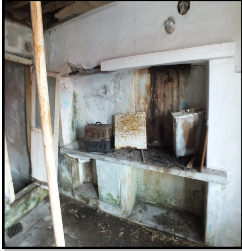
Görsel 433. Tescilli Ev 14, Zemin Kat Giriş Görünüşü (Trabzon Rölöve ve Anıtlar Müdürlüğü Sokak Sağlıklaştırma Projesinden)
