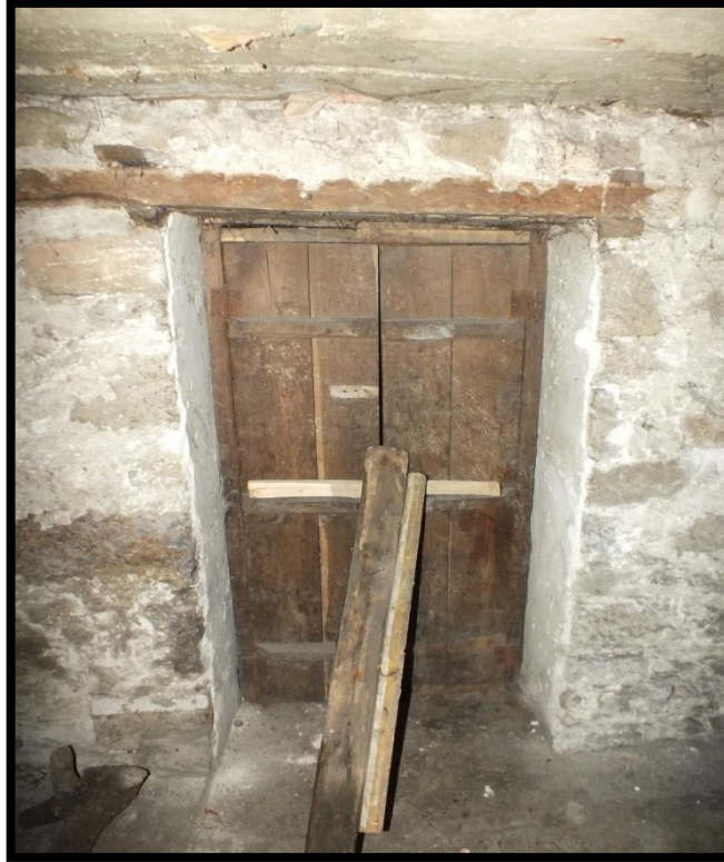
Görsel 212. Tescilli Ev 5, Bodrum Katı Oda Görünüşü (Trabzon Rölöve ve Anıtlar Müdürlüğü Sokak Sağlıklaştırma Projesinden)
