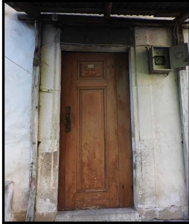
Görsel 300. Tescilli Ev 8, İkinci Kat Giriş Görünüşü (Trabzon Rölöve ve Anıtlar Müdürlüğü Sokak Sağlıklaştırma Projesinden)
