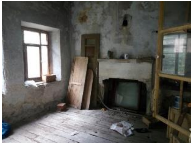
Görsel 160. Tescilli Ev 2, Birinci Kat Birinci Oda Ocak (Trabzon Rölöve ve Anıtlar Müdürlüğü Sokak Sağlıklaştırma Projesinden)
