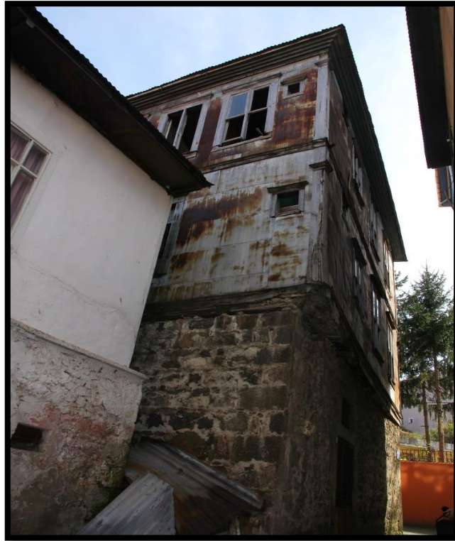
Görsele 174. Tescilli Ev 3,, Güney Cephesi Görünüşü (Trabzon Rölöve ve Anıtlar Müdürlüğü Sokak Sağlıklaştırma Projesinden)
