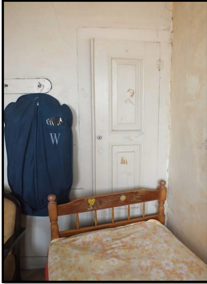
Görsel 333. Tescilli Ev 9, İkinci Kat Odalardan Görünüş (Trabzon Rölöve ve Anıtlar Müdürlüğü Sokak Sağlıklaştırma Projesinden)
