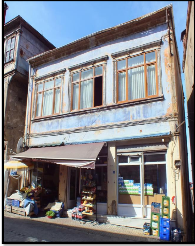
Görsel 207. Tescilli Ev 5, Güney Cephesi Görünüşü (Trabzon Rölöve ve Anıtlar Müdürlüğü Sokak Sağlıklaştırma Projesinden)
