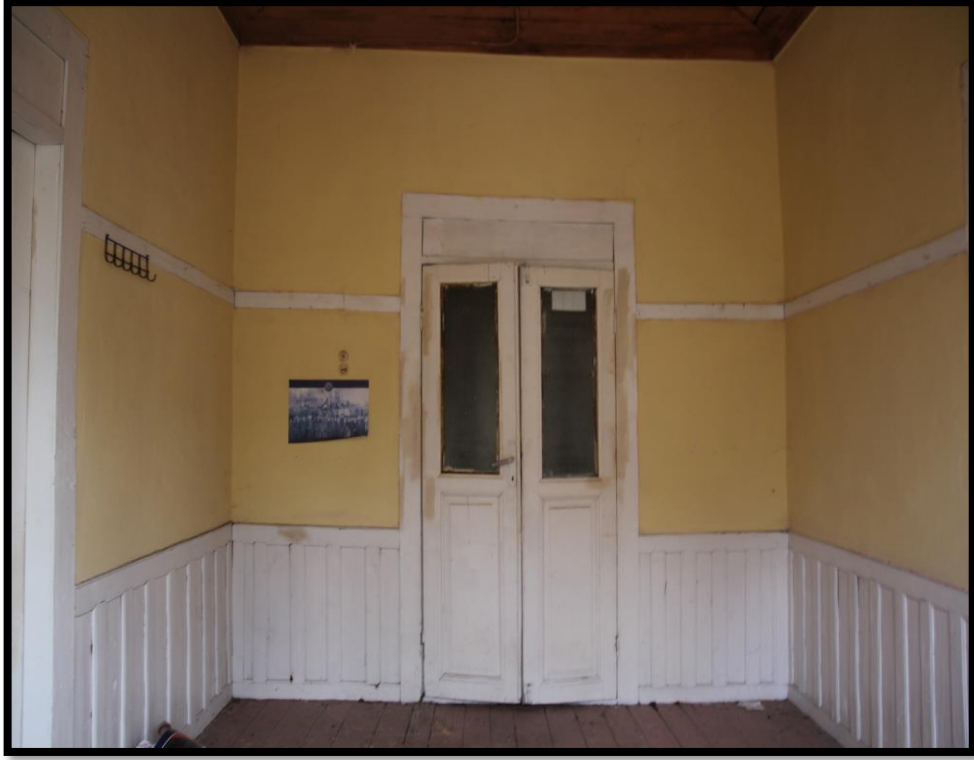
Görsel 145. Tescilli Ev 1, Birinci Kat Oda Görünüşü (Trabzon Rölöve ve Anıtlar Müdürlüğü Sokak Sağlıklaştırma Projesinden)
