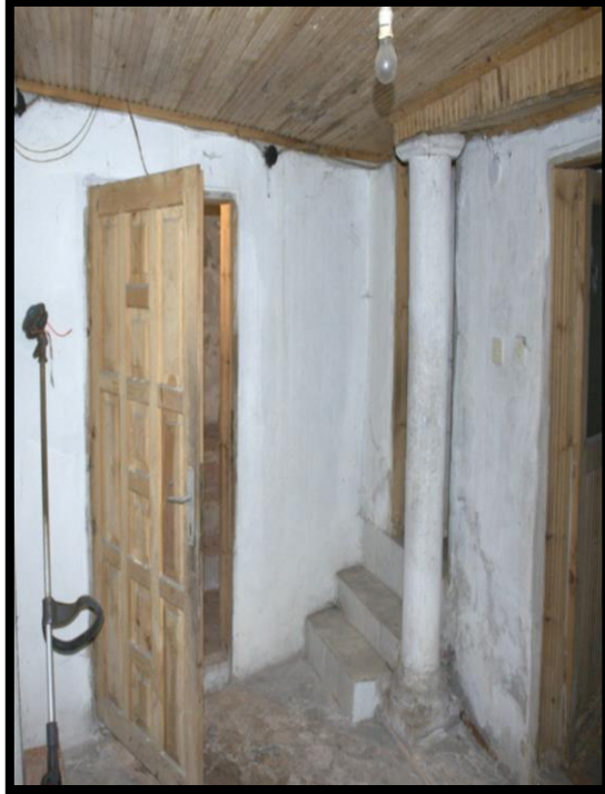
Görsel 216. Tescilli Ev 5, Bodrum Katından Görünüş (Trabzon Rölöve ve Anıtlar Müdürlüğü Sokak Sağlıklaştırma Projesinden)
