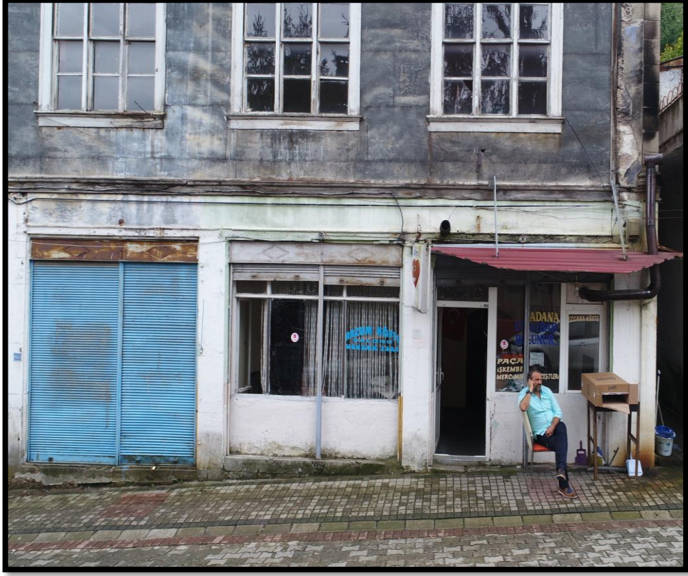
Görsel 139. Tescilli Ev 1, Zemin Kat Dükkan Görünüşü (Trabzon Rölöve ve Anıtlar Müdürlüğü Sokak Sağlıklaştırma Projesinden)
