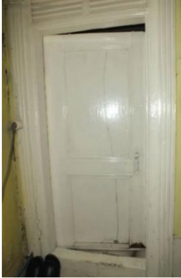
Görsel 442. Tescilli Ev 14, Tuvalet-Banyo Bölümüne Giriş Sağlayan Kapı (Trabzon Rölöve ve Anıtlar Müdürlüğü Sokak Sağlıklaştırma Projesinden)
