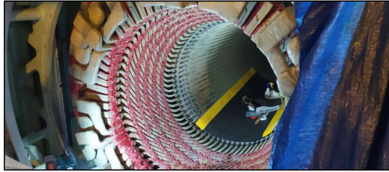
Şekil 2.12 Jeneratör iç kısmı
