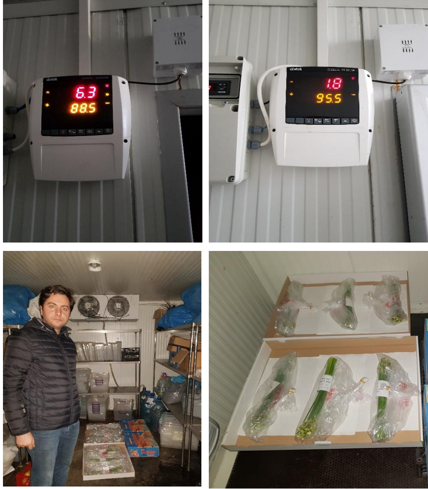
Şekil 3.4 Soğuk Hava Deposu Koşulları
