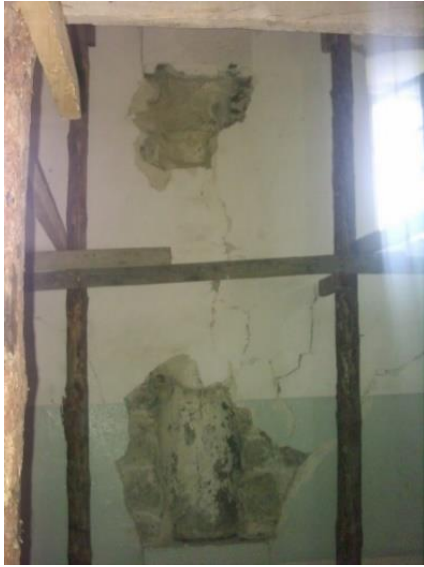
Görsel 74. 1996 Depreminde Doğu Duvarda Oluşan Hasar (M. Doğanbaş Arşivi)
