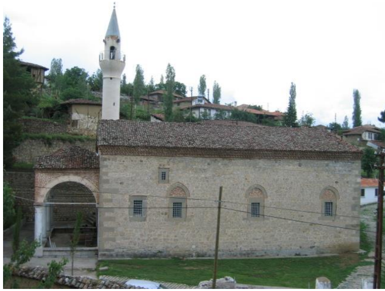
Görüş 58. Güney Cephe, Restorasyon Öncesi (Tokat VBM Arşivi)
