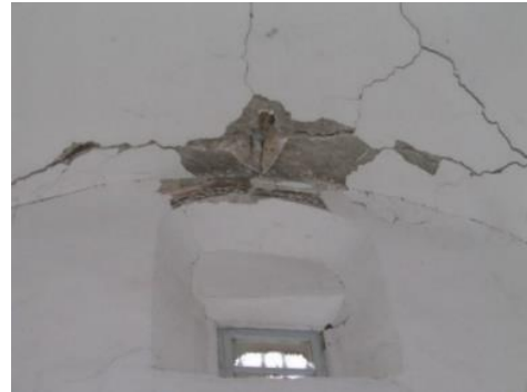
Görsel 75. 1996 Depreminde Tonozda Oluşan Hasar (Tokat VBM Arşivi)
