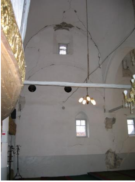
Görsel 72. Örtü Sistemindeki Çatlaklar, Restorasyon Öncesi (Tokat VBM Arşivi)
