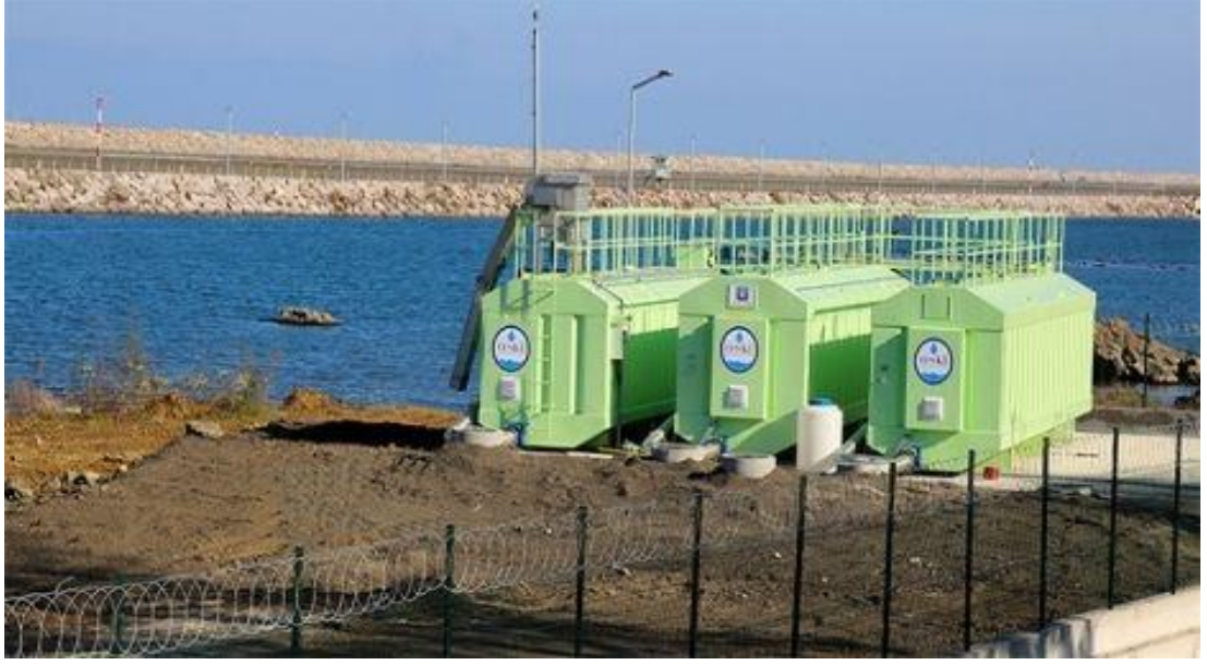
Şekil 1.13 Ordu İli Gülyalı İlçesi Paket Atıksu Arıtma Tesisi
