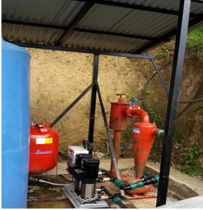
Şekil 3.5 Sulama amaçlı kurulan 2,2 kWh dikey pompa
