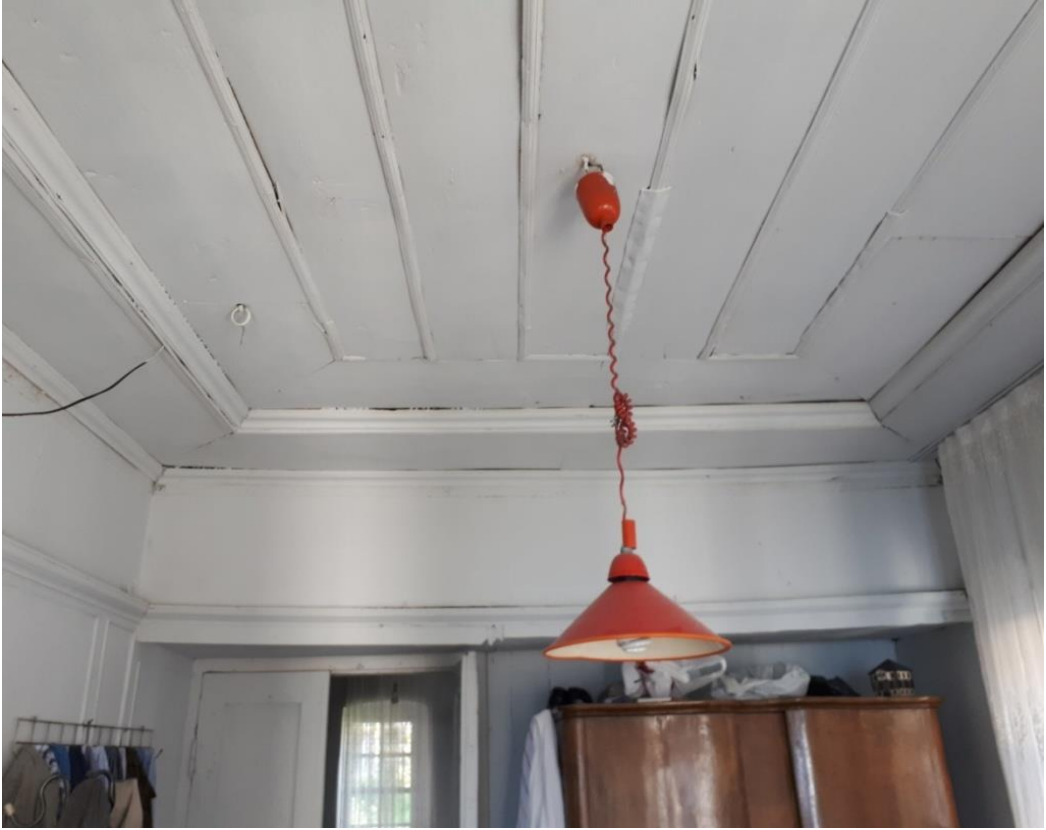
Görsel 52. Birinci Kat Kuzeydoğu Odanın Tavanı.
