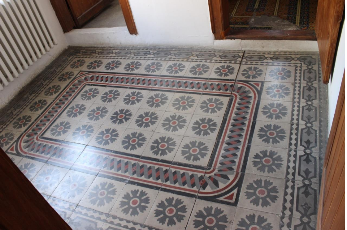
Görsel 56. İkinci Kat Tuvalet ve Banyo Önündeki Zemin Döşemesi (Sibel Güngör)
