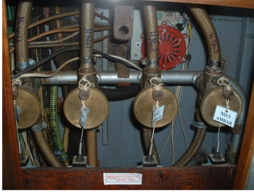
Resim 2.10: Sabit söndürme sisteminde köprü üstüne ait üç yollu valf
