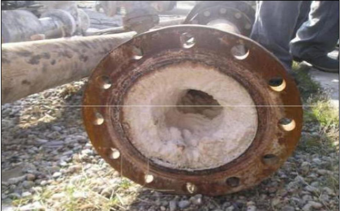
Şekil 3.14 Jeotermal Borularda Kalsiyum Karbonat ( \text{CaCO}_3 ) Kabuklaşması
