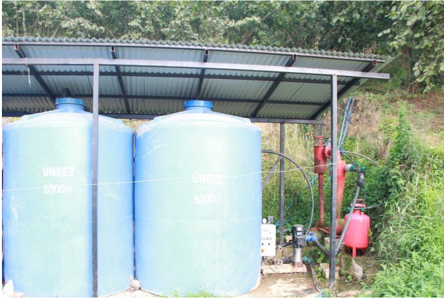
Şekil 3.14 Sulama amaçlı kurulan PV sistem dikey pompa
