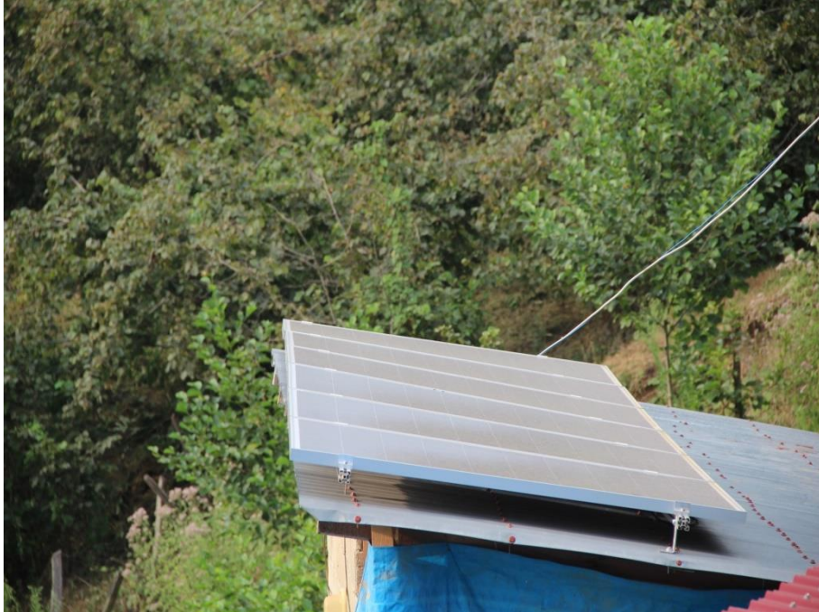
Şekil 3.12 Sulama amaçlı kurulan PV sistemin fotovoltaik panelleri
