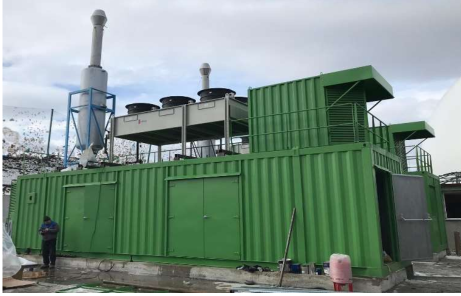
Şekil 4.6 Düzenli Depolama Tesisi gaz motoru görseli
