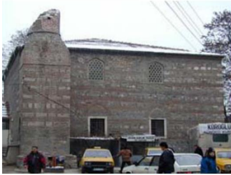
Şekil 2.2 Kocaeli Depremi'nde yıkılan yığma minare (Doğangün ve ark., 2006)
