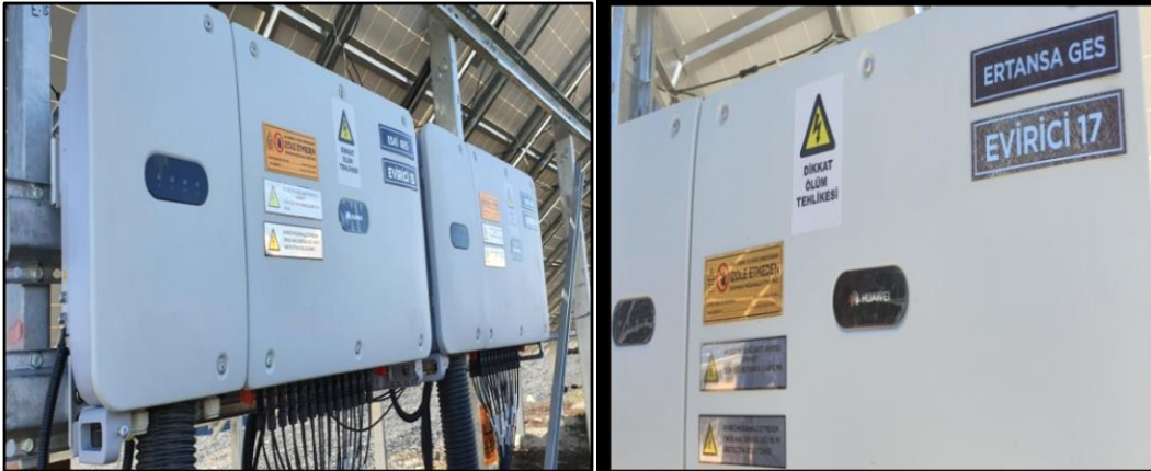
Şekil 2.17 Erzurum 4.9MWe Gücünde Güneş Enerji Santrali'ne Ait İnvörtörler
