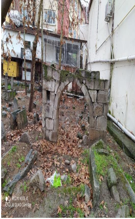
Görsel 3. Türbe Duvarı Genel Görüntü.
