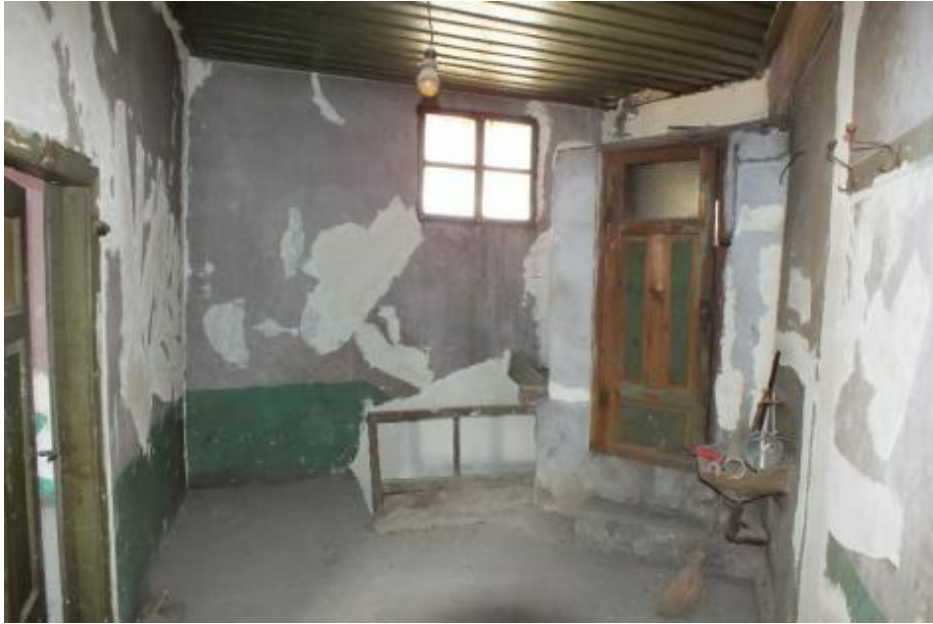
Görsel 68: Yüksek Kahve Binası Birinci Kat Bölümü Odaları Restorasyondan Önceki Hali
