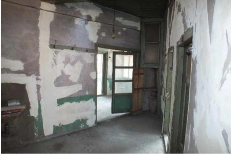
Görsel 67: Yüksek Kahve Binası Birinci Kat Bölümü Odaları Restorasyondan Önceki Hali
