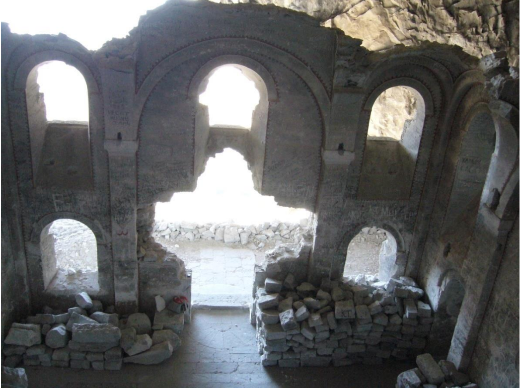
Görsel 85. Restorasyon Öncesi Kilise Batı Duvarı (Trabzon Rölöve ve Restorasyon Anıtlar Kurulu)
