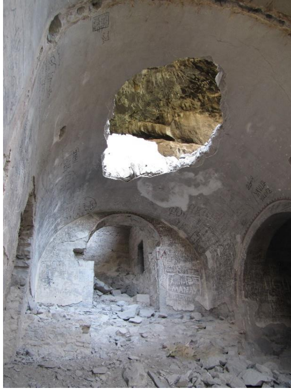
Görsel 19. Restorasyon Öncesi İkinci Kat ve Yıkılmış olan Üst Örtü (Trabzon Rölöve ve Restorasyon Anıtlar Kurulu)
