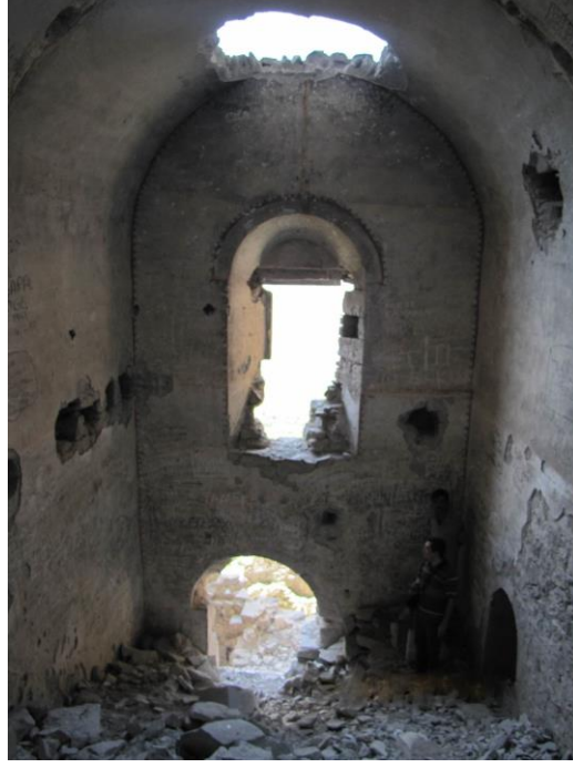
Görsel 21. Restorasyon Öncesi İkinci Kat ve Mazgal Pencere (Trabzon Rölöve ve Restorasyon Anıtlar Kurulu)
