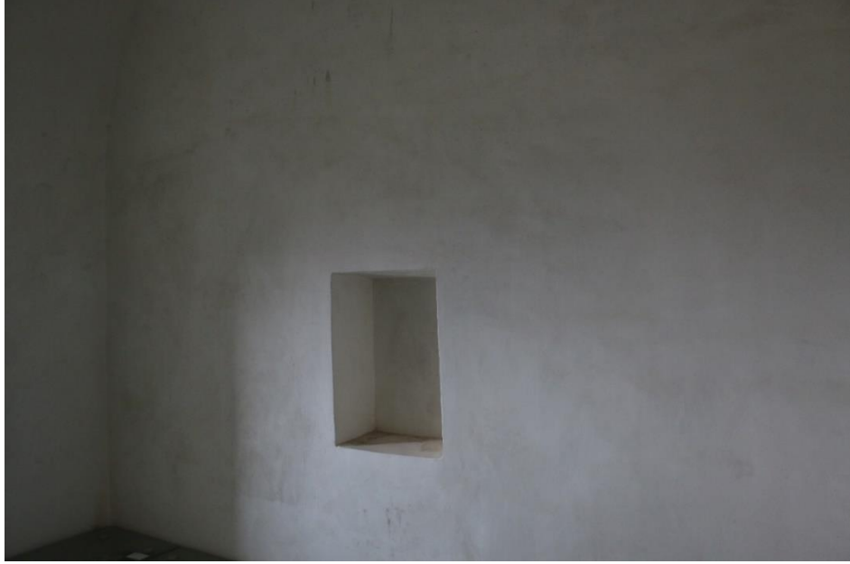
Görsel 52. Restorasyon Sonrası İkinci Kademedeki Koridorun Sağındaki Yemek Salonu Kuzey Duvarındaki Niş
