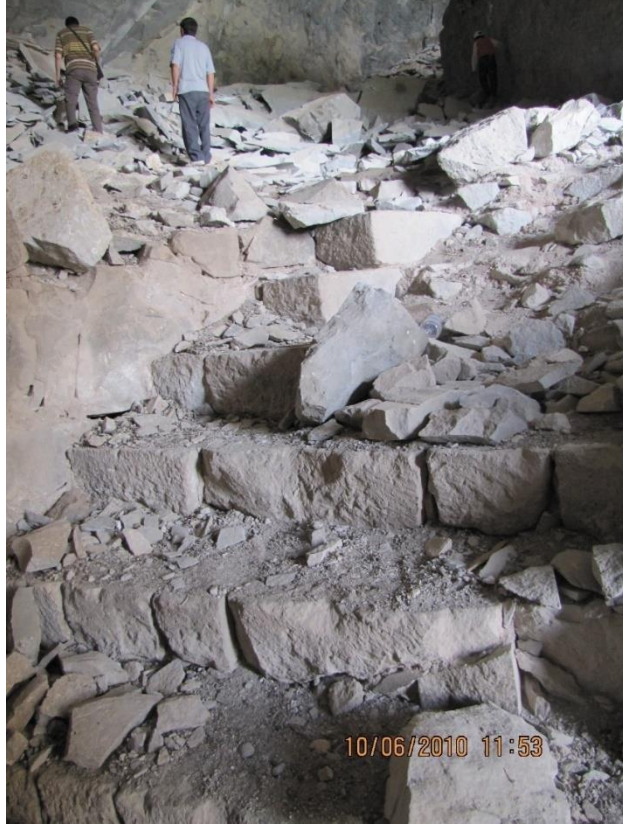
Görsel 69. Restorasyon Öncesi Üçüncü Kattan Kiliseye Çıkılan Merdiven (Trabzon Rölöve ve Restorasyon Anıtlar Kurulu)
