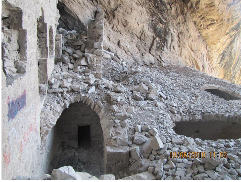
Görsel 61. Restorasyon Öncesi İkinci Kademedeki Üçüncü Kat Teras Hücrelerin Ön Kısmı (Trabzon Rölöve ve Restorasyon Anıtlar Kurulu)
