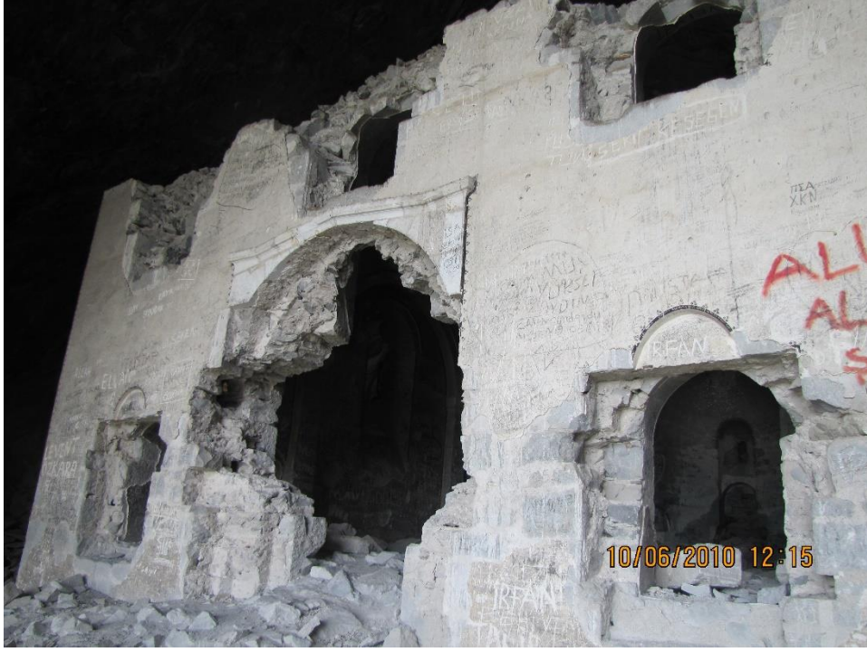
Görsel 73. Restorasyon Öncesi Kilisenin Batı Cephesi (Trabzon Rölöve ve Restorasyon Anıtlar Kurulu)
