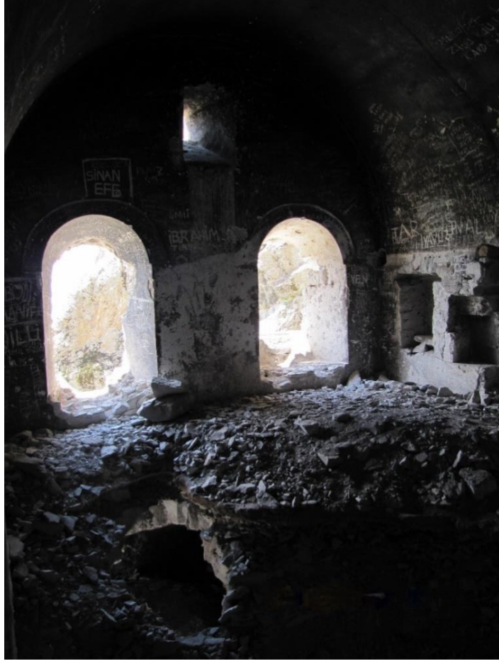
Görsel 35. Restorasyon Öncesi İkinci Kademinin Kuzeydeki Odanın İçi (Trabzon Rölöve ve Restorasyon Anıtlar Kurulu)
