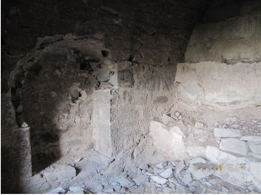
Görsel 67. Restorasyon Öncesi İkinci Kademedeki Üçüncü Kat Terasındaki En Kuzeydeki Hücresinin Kuzey Duvarındaki Niş (Trabzon Rölöve ve Restorasyon Anıtlar Kurulu)
