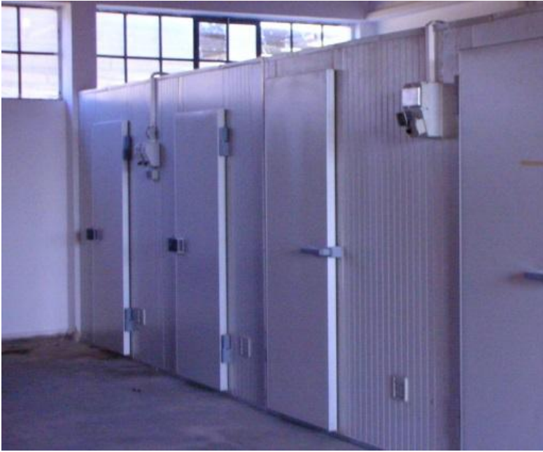
Şekil 3.3. Çalışmanın yürütüldüğü soğuk hava odaları
